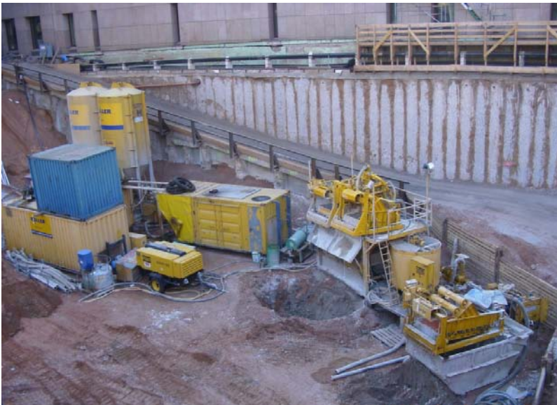
Bild 2.2: Mischanlage, Hochdruckpumpe und Regenerierung für das Düsenstrahlverfahren
